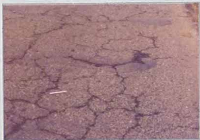
Рис. 6.7. Сетка трещин на асфальтобетонном покрытии
