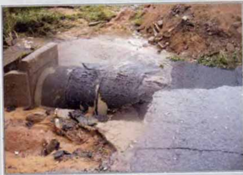
Рис. 6.27. Разрушения участка дороги в результате дефекта трубы
