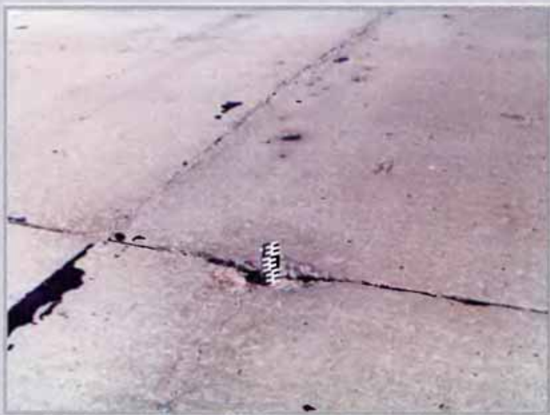
Рис. 6.21. Повреждение кромок швов
